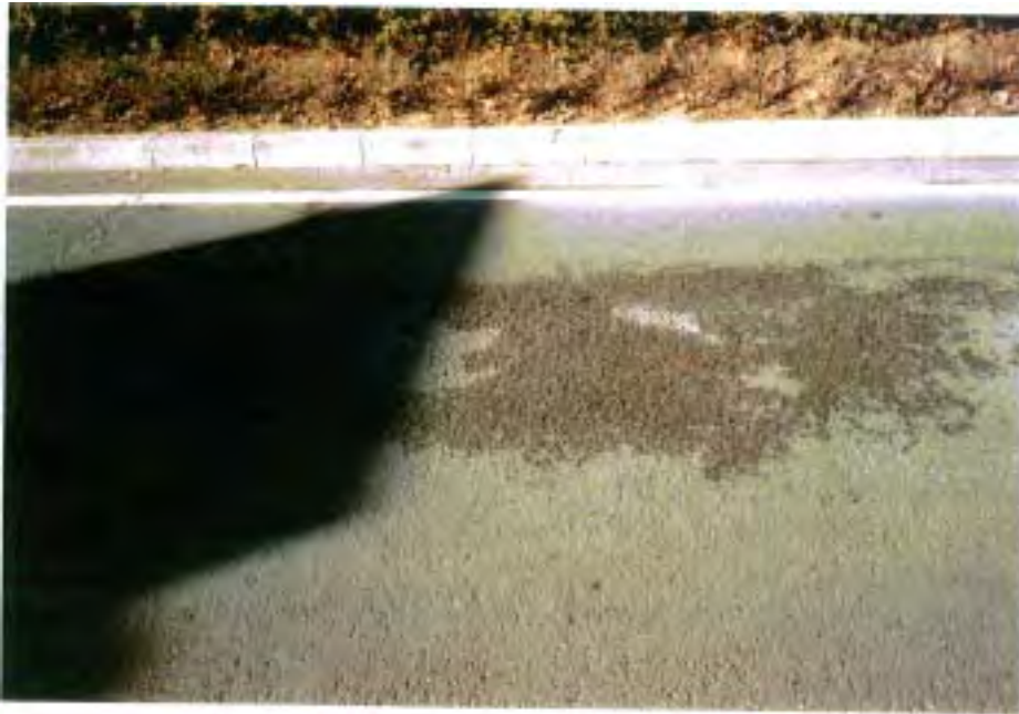
骨材飛散箇所 調査対象反対車線 終点側
