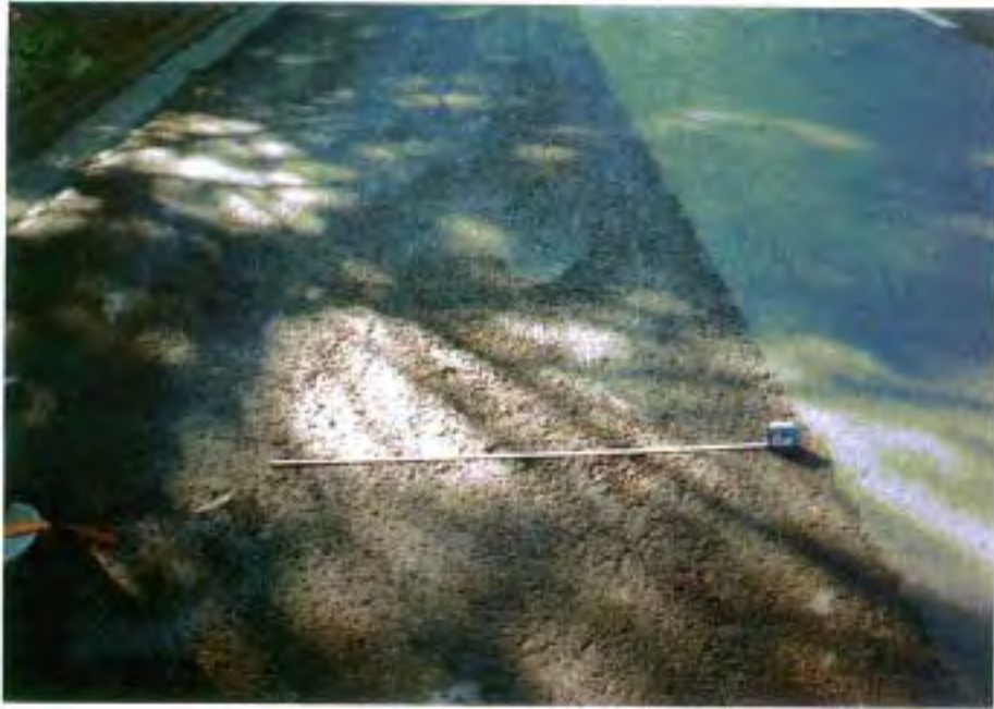
骨材飛散箇所
