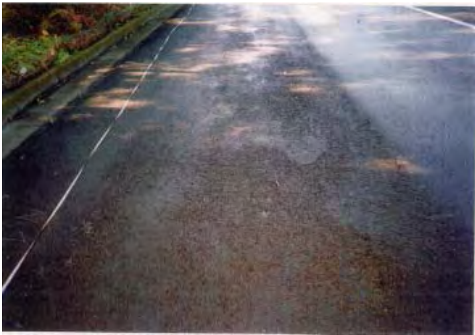
写真 - 3 骨材飛散部
